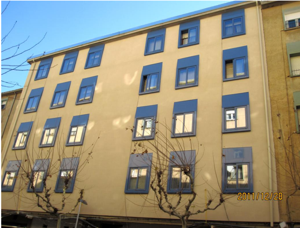
Adecuación de la envolvente en los Bloques, Calle Robles Pintado 5 Proyecto LOURDES RENOVE
