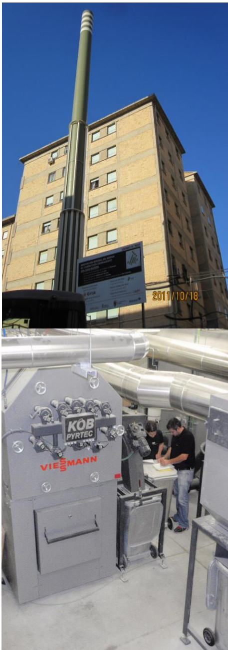
Sala de calderas de biomasa en calle Azcona Gamén 6, Tudela.
